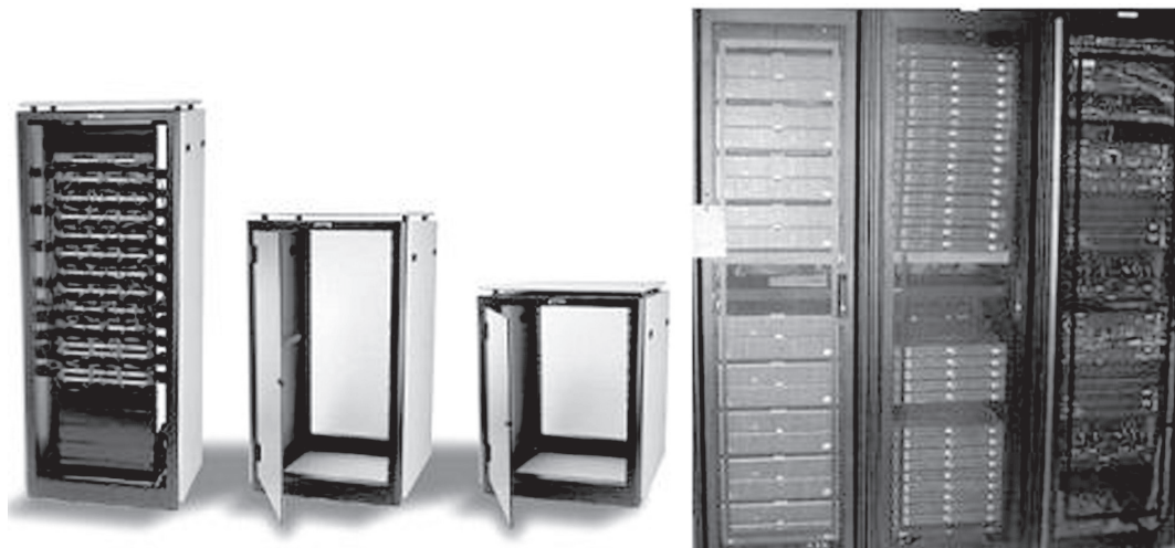
Slika 31: Grupa servera smještenih u specijalne ormare.
